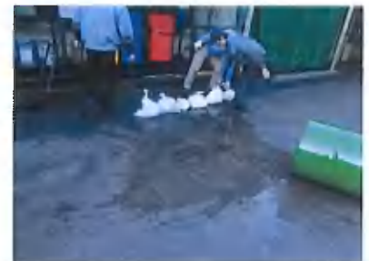
側溝への油流出防止
